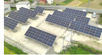
FSPS飯山市木島発電所 運転開始年月日：令和5年12月 出力：100.0 kW 年間CO2削減量：約91.0 t
